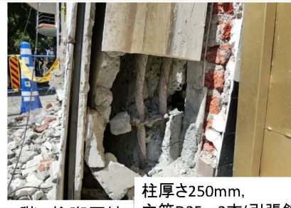
1階 柱脚圧壊 柱厚さ250mm, 主筋D25 2本(引張鉄筋) せん断補強筋D10@250
