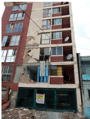
非構造煉瓦壁の損傷 2階梁のたわみ(曲げひび割れ)
