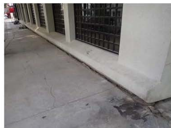
周辺地盤の沈下
