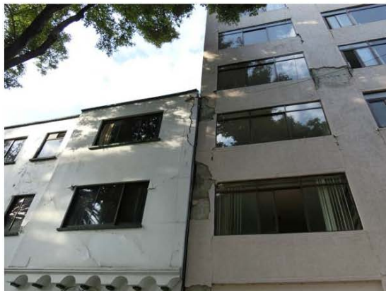
隣の建物との衝突による被害
