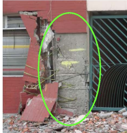
せん断破壊した柱 主筋の座屈
