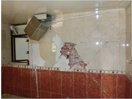
非構造煉瓦壁のせん断破壊
