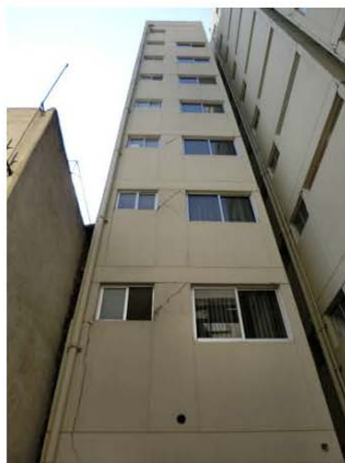
非構造煉瓦壁せん断破壊
