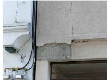
柱幅切り替え部分での損傷(2F梁)
