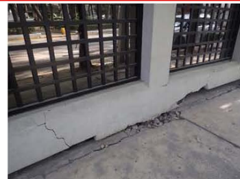
基礎梁の損傷
