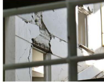
開口上部梁の損傷
