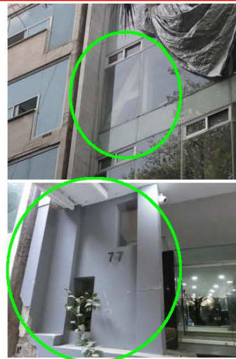
1985年の地震後、1階は袖壁、 上階はブレースによる補強
