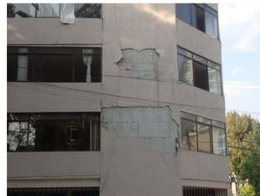
外壁の損傷、仕上げ材の剥落
