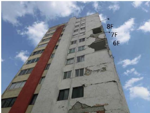
上階の組積壁の崩落
