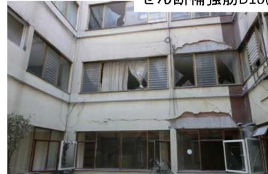
非構造壁(腰壁)の損傷 吹き抜け内側
