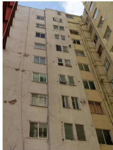
非構造煉瓦壁せん断破壊
