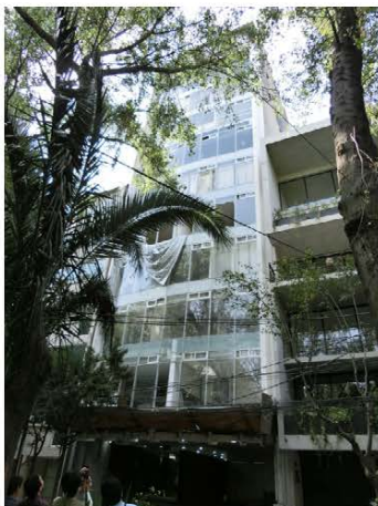
壁にひび割れ、窓ガラス破損
