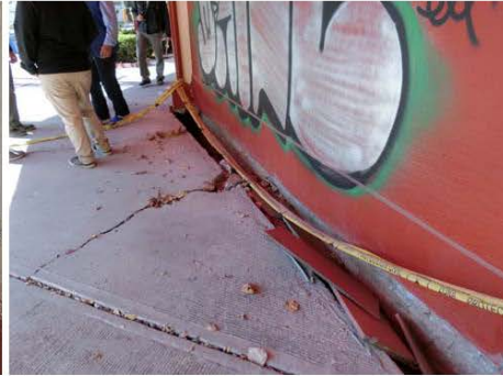
建物周辺地盤の沈下
