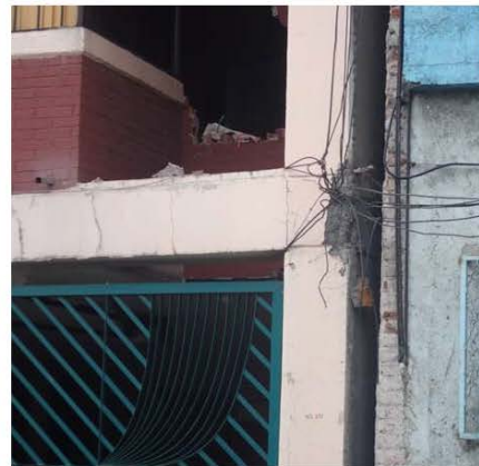
柱梁接合部の損傷
