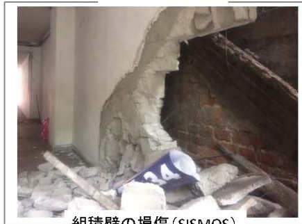
組積壁の損傷 (SISMOS)
