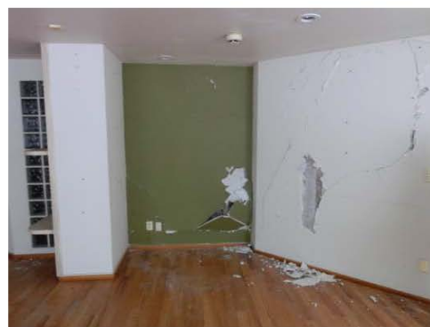
非構造内壁(煉瓦壁)の被害状況
