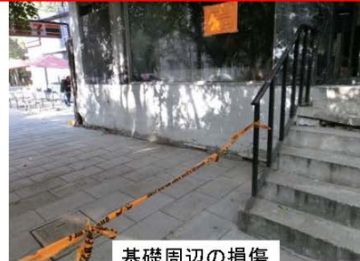
基礎周辺の損傷
