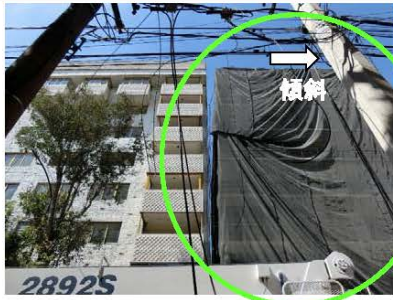
北側の隣棟(RC造地上8階建て)は北側 が下がる向きに建物全体が傾斜
