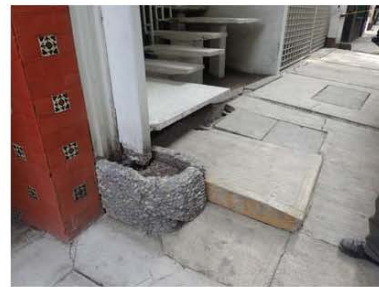
地盤の沈下・変形
