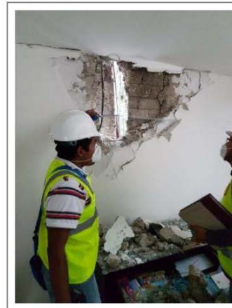
建物内部の被害(SISMOS)
